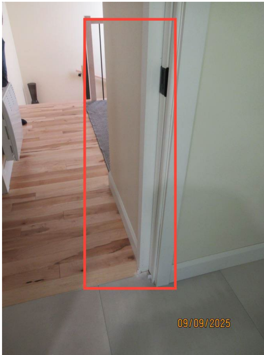
Porte avant les correctifs
