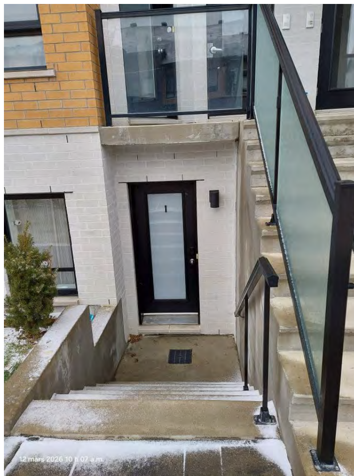
Main courante a ajouter aux descentes avant
