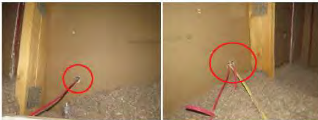
Illustration 333 et Illustration 334: Mur mitoyen non-retardant/non-étanche observé escalier 5700
