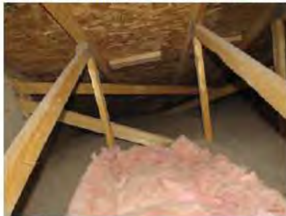
Illustration 345: Trappe d'accès inadéquate 5500 <exemple>
