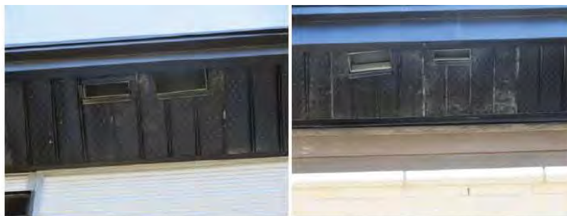
Illustration 283 et Illustration 284: Grilles/trappes pour les sorties de ventilation est manquants avant 5600 et 5700 <exemple>
