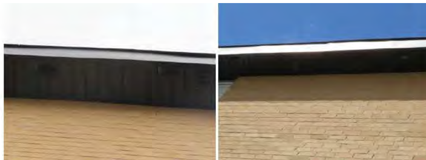
Illustration 285 et Illustration 286: Grilles/trappes pour les sorties de ventilation est manquants gauche 5600 et droit 5700 <exemple>
