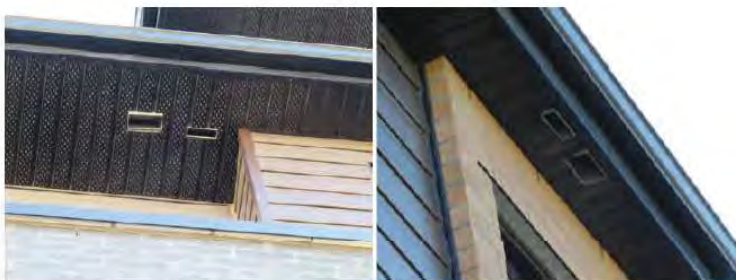
Illustration 287: Grilles/trappes pour les sorties de ventilation est manquants avant 5400 <exemple>
