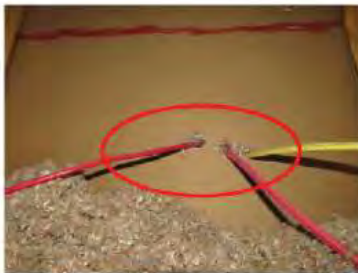
Illustration 331 et Illustration 332: Mur mitoyen non-retardant/non-étanche observé escalier 5600
