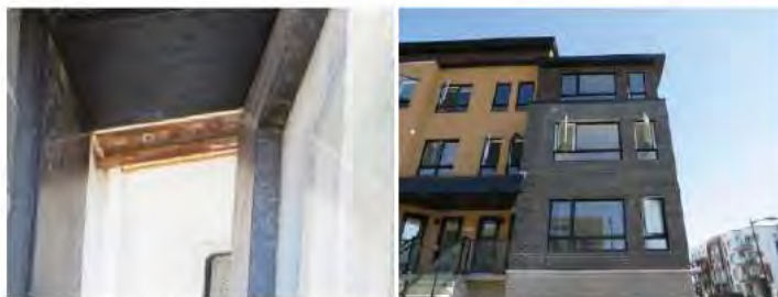
Illustration 178 et Illustration 179: Mécanisme de fenêtre rouillées avant 5700
