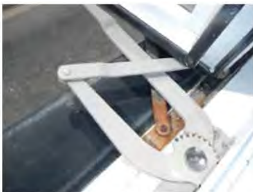
Illustration 180: Mécanisme de fenêtre rouillées avant 5700-6
