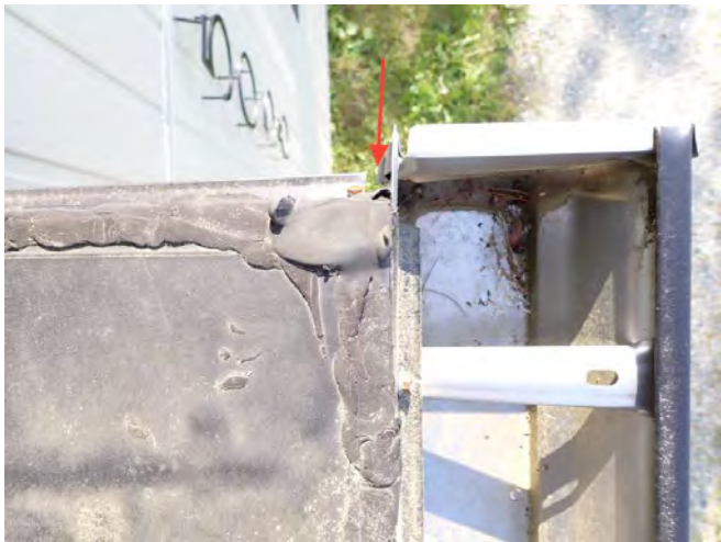
Larmier non continu et présence de quantité excessive de scellant
