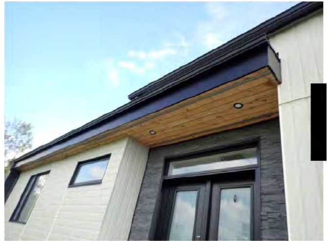
Il faudra retirer tout le soffite de bois à cet endroit. Les grillages également seront retirés.
