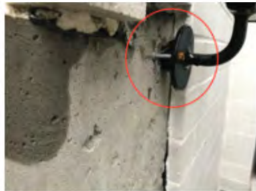
7305 - Unité 1 - Main courante mal fixée
