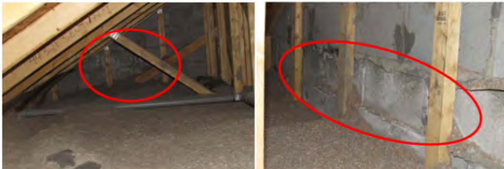
Illustration 279 et Illustration 280: Signes d'efflorescence au mur coupe-feu 7205-5 et 7405-6
