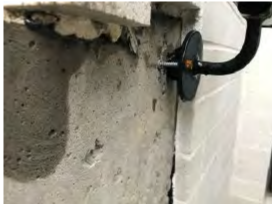
Exemple de main courante mal fixée
