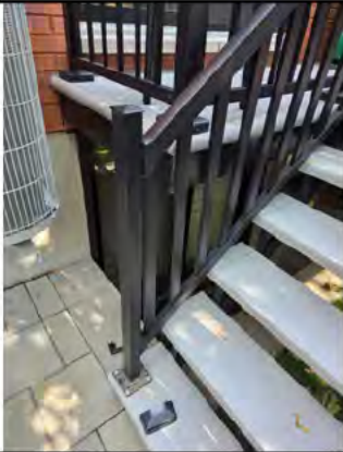
Escalier arrière - Il faudra prévoir la mise en place de deux pieux sous les limons et ajuster le pavé.
