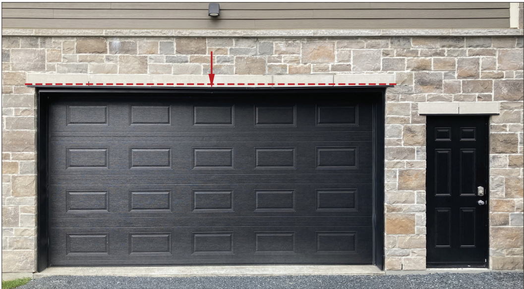
Figure 9.20. - 01.3 Flèche d'un linteau d'acier
