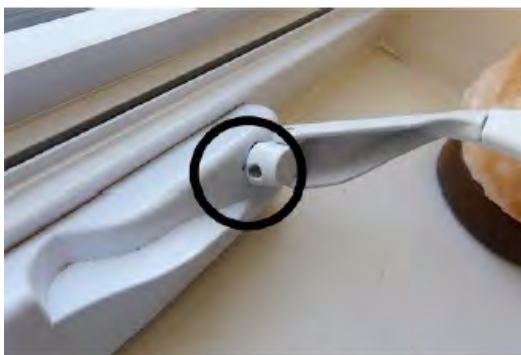
Au 353 absence de vis sur la manivelle.
