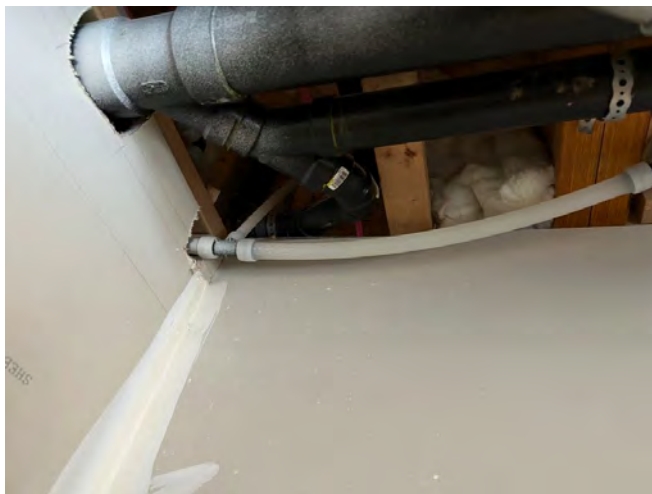
MANQUE D'ISOLANT RIVE MUR MITOYEN
