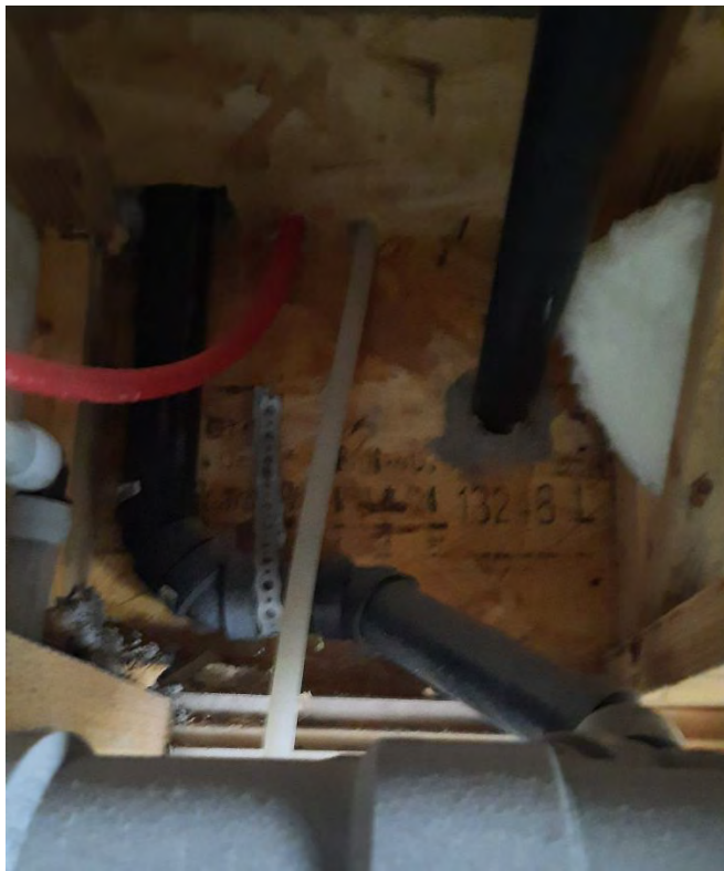
MANQUE D'ISOLANT RIVE MUR MITOYEN
