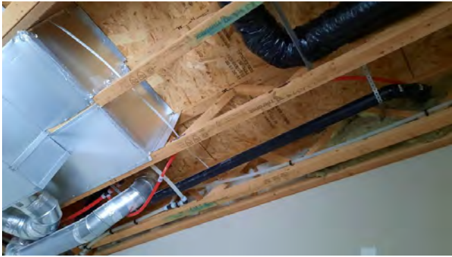
ESPACE DISPONIBLE POUTRELLES INSTALLATION CONDUIT VENTILATION
