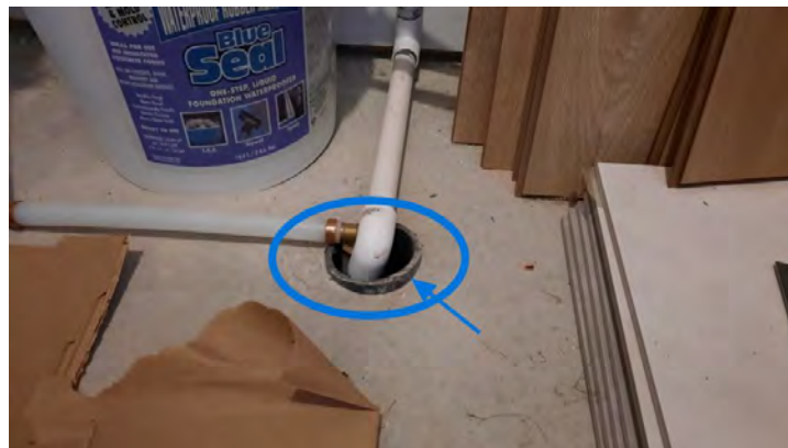
DRAIN DE PLANCHER TROP HAUT
