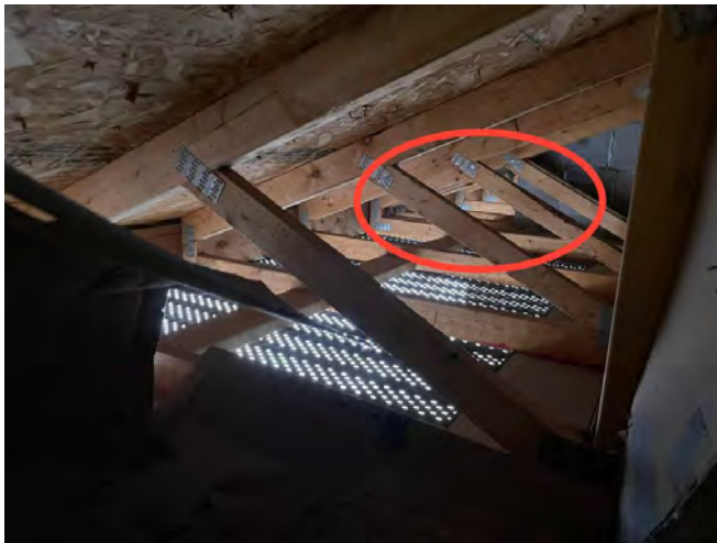
ABSENCE DE PARE-FEU DÉBORD DE TOIT
