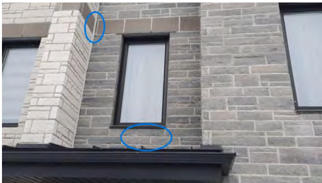
FISSURES JOINTS DE MORTIER TOIT DE L'ENTRÉE AVANT
