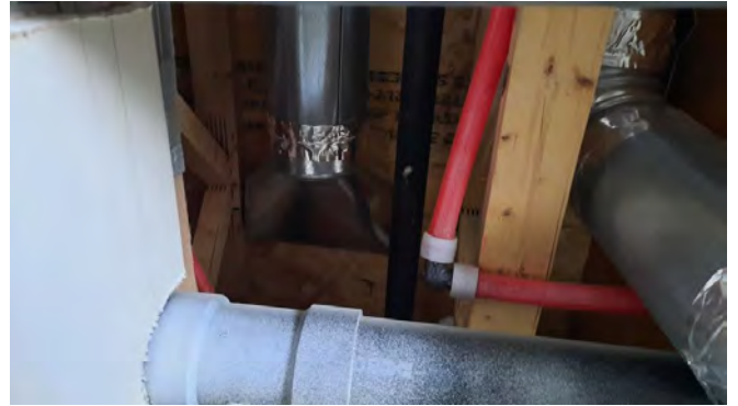
CONDUIT D'AIR SALLE DE TOILETTE
