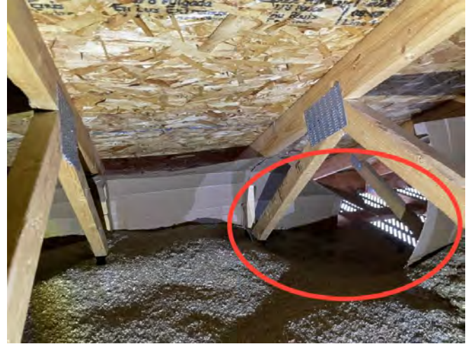
DÉFLECTEUR ET ISOLANT DÉPLACÉS VIDE SOUS-TOIT
