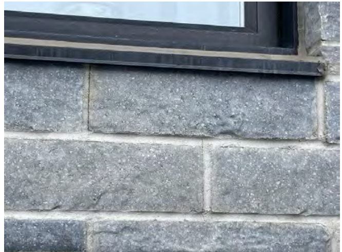
FISSURES JOINTS DE MORTIER TOIT DE L'ENTRÉE AVANT
