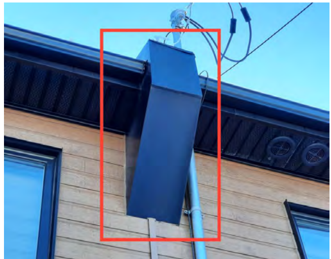
S'ASSURER DE L'ÉTANCHÉITÉ DE L'EXCÉDENT MUR COUPE-FEU
