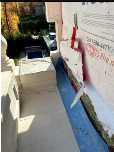
Jonction mur et balcon du 2e étage
