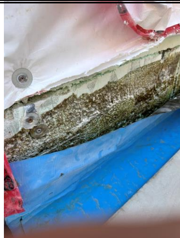
Jonction mur et balcon du 2e étage
