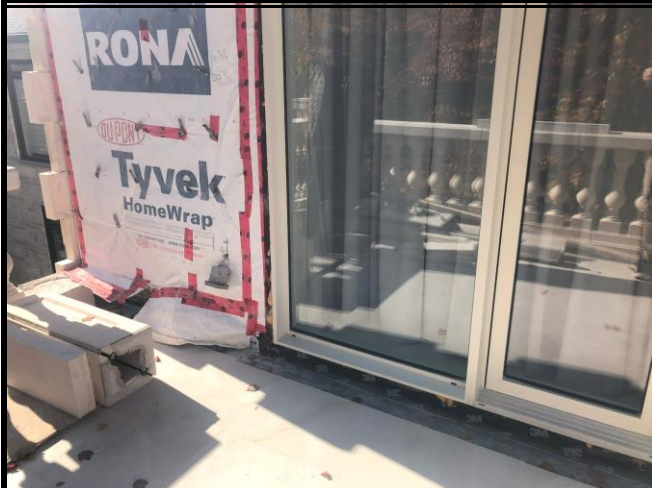
Jonction mur et balcon du 2e étage
