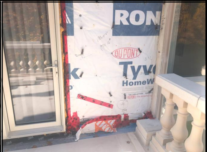
Jonction mur et balcon du 2e étage
