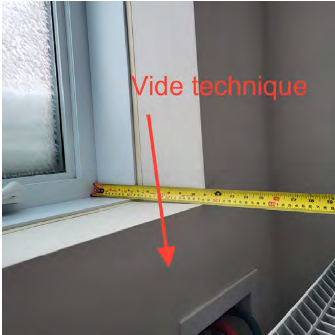
Mur extérieur de la salle de lavage où va passer le conduit réfrigérant et le câblage électrique de la thermopompe
