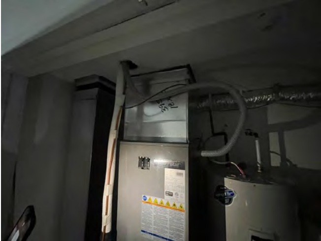
Câble électrique et conduit réfrigérant de la thermopompe présents dans une salle mécanique
