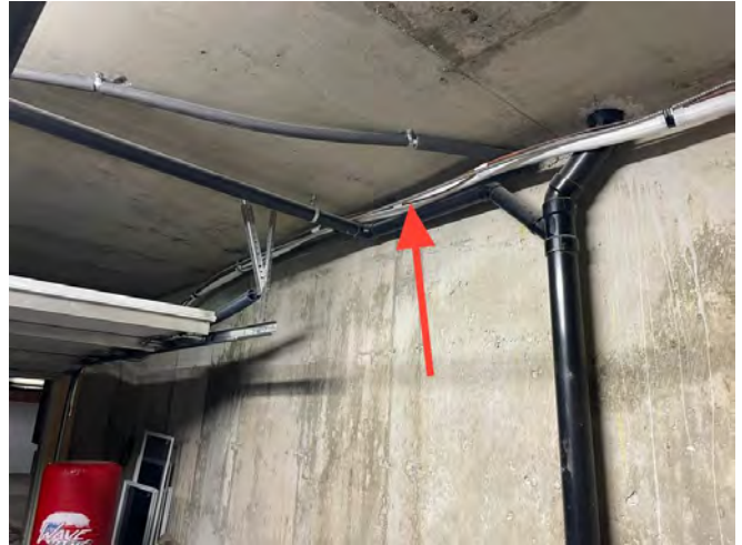
Conduit réfrigérant et câble électrique au plafond d'un garage
