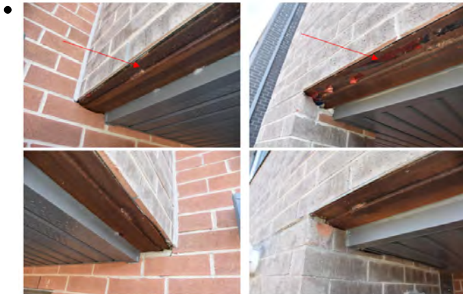
Linéau corrodé – avant du bâtiment.
