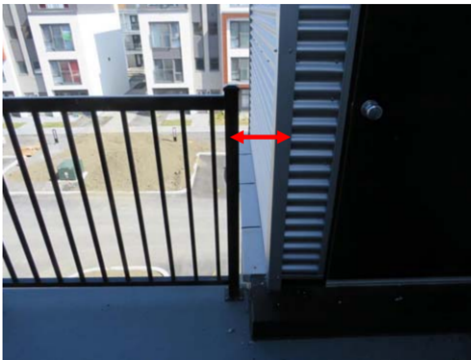
Espacement non conforme
